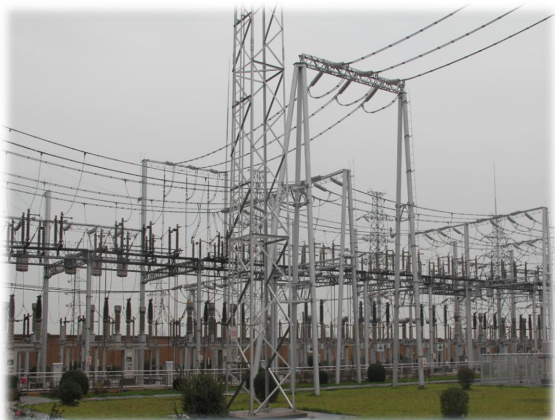
变电站设备区
